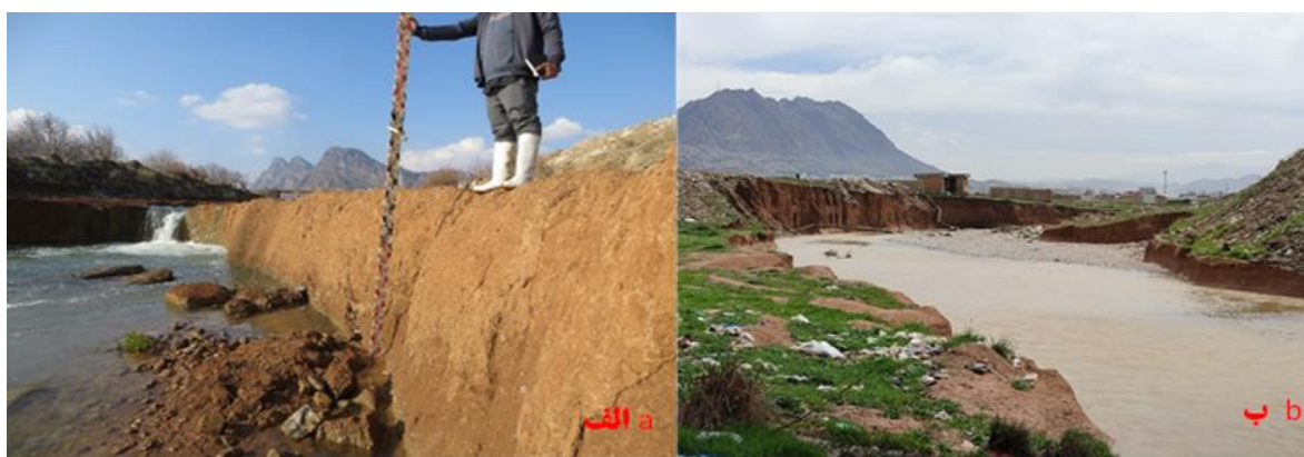
شکل ۵- الف) برش بستر رودخانه، ب) فرسایش حاشیه رودخانه در بخش اول
